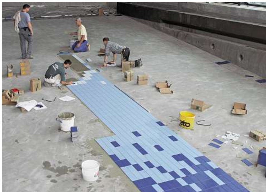
Die Arbeit der Plattenleger im Wellenbereich gleicht einem Mosaik. Sie verlangt höchste Konzentration.
