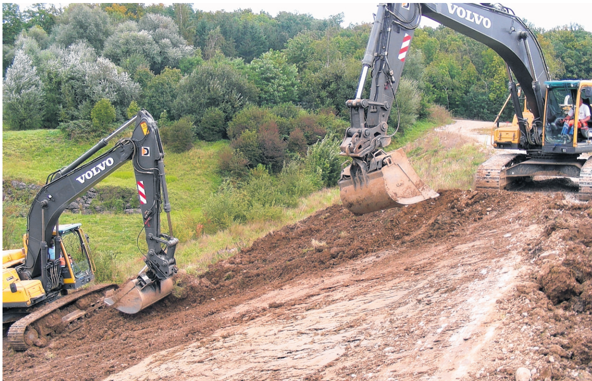
Das Bord zum bestehenden Naturschutzgebiet (links) wird naturnah umgestaltet und künftig extensiv genutzt.
